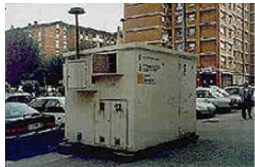
Estación de control de la calidad del aire en la Avda. Argentina
